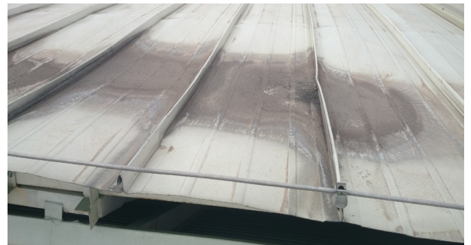
Deflexión de una cubierta que causa empozamiento y acumulación de sedimentos. No hay colapso del elemento.
