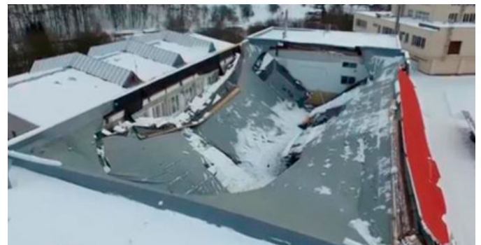
Acumulación de Granizo en una cubierta. Se presenta Colapso del elemento.
